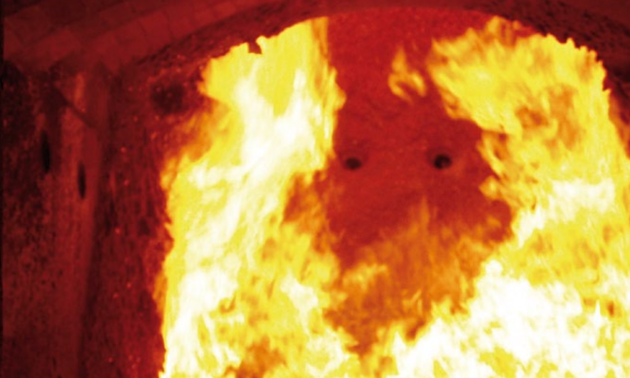
Ein Blick in den Brennraum des Biomassekessels
